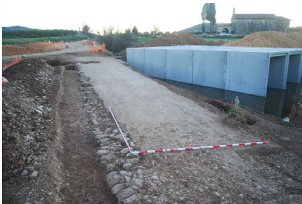
FIGURA 8: Excavació de la via a la Salzadella l'any 2014 (Fotografia: R. Pérez Milián)
